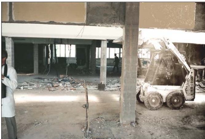
Démolition à la masse et à la pelleuse sans aucune protection. PSO
