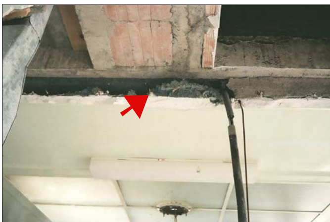
Cet amiante recouvrait les faux plafonds en lattis de roseaux. PSO
