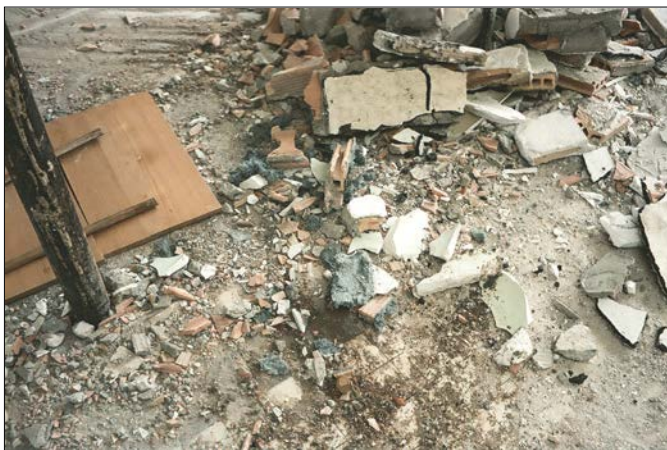
Briques, plâtre, gravas, amiante bleu, tout y était mêlé. PSO
