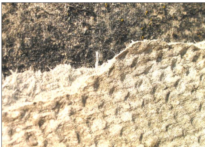
Les innombrables mèches d'amiante affleurent des brisures d'Eternit.
