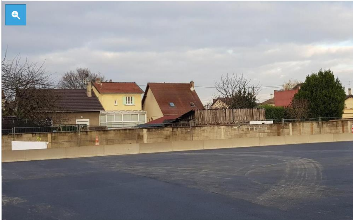
Aulnay. Limitrophe d'un chantier municipal, un mur truffé d'amiante, vestige du CMMP, a été découvert à Aulnay-sous-Bois. Il sera démolé sous confinement en février. DR
